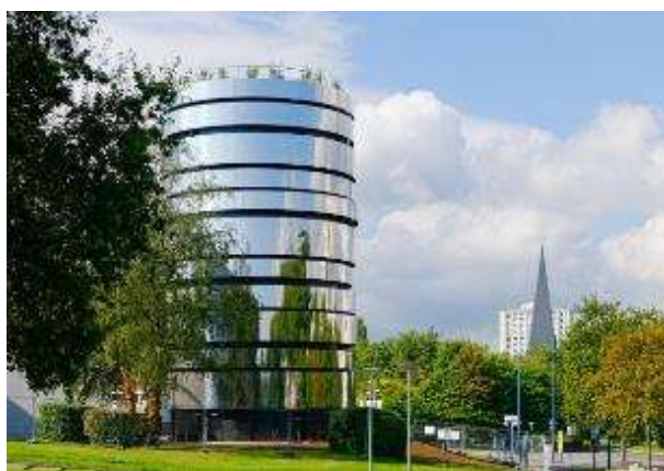
Figure 86. 1 cuve de 1000 m 3 à pression atmosphérique à Brest [Source : Dalkia]
