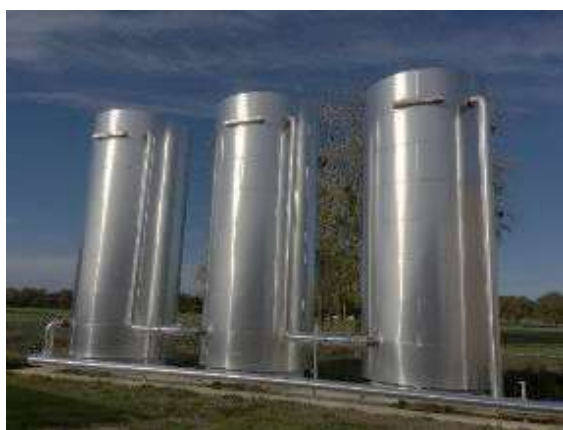
Figure 85 : 3 ballons sous pression préfabriqués de 50 m 3 à Chateaubriant [source : Ville de Chateaubriant]
