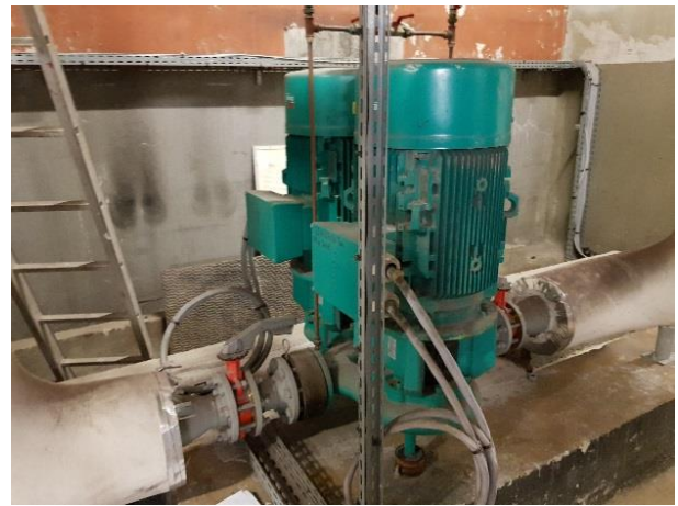
Figure 18 : Pompes de distribution en sous-station (Bondy Habitat)
