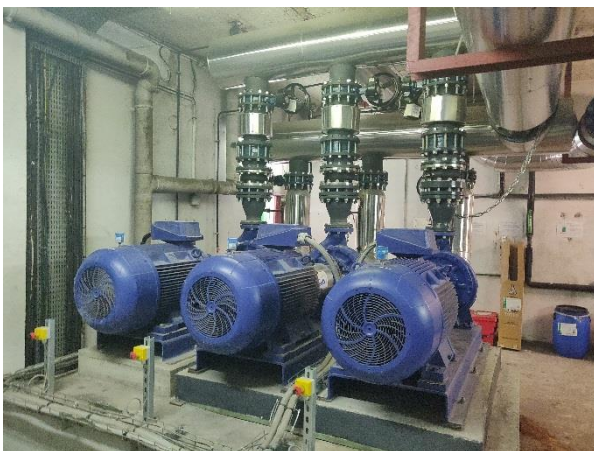
Figure 10 : photo des pompes de distribution
