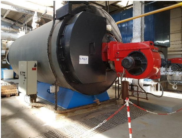
Figure 6 : vue d'ensemble de la chaudière n+2
