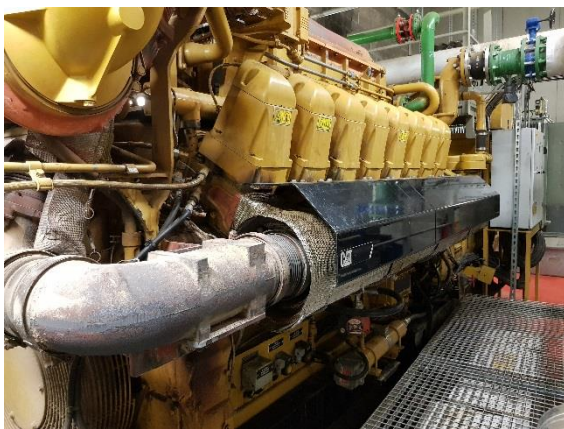
Figure 4 : photo du moteur de la cogénération
