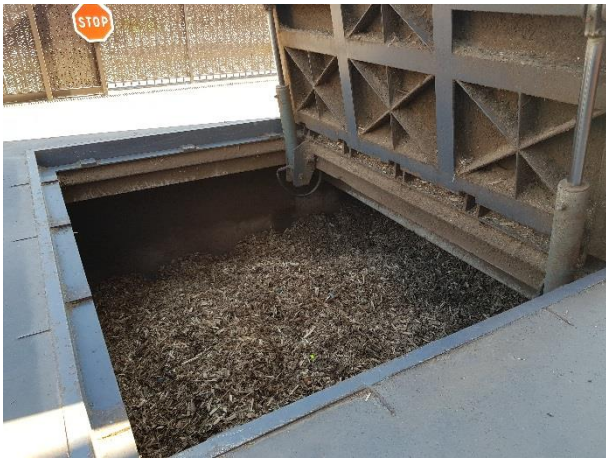
Figure 13 - Silo d'alimentation en bois
