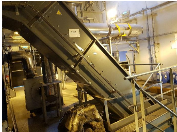
Figure 134 - Transporteur alimentant le foyer
