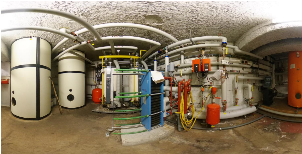
Figure 20 : Photo 360 d'une sous-station
