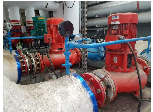
Figure 9 : photo des pompes de charge
