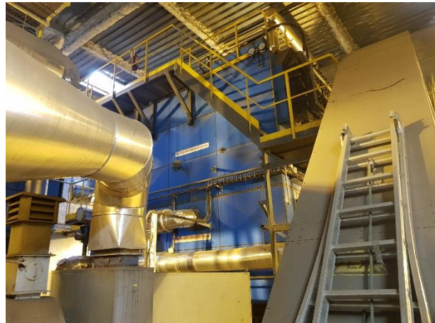
Figure 16 - Vue d'ensemble de la chaudière de 4 MW
