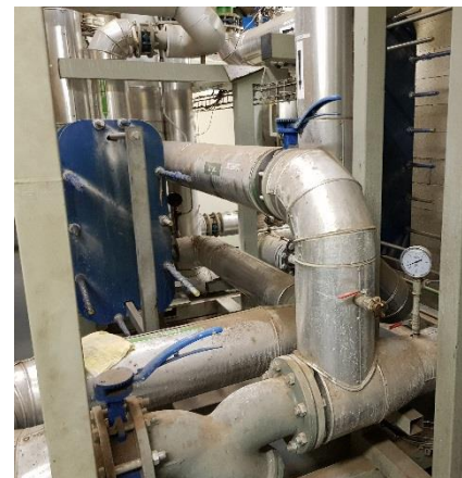
Figure 3 : photo des échangeurs niveaux 1 et 2
