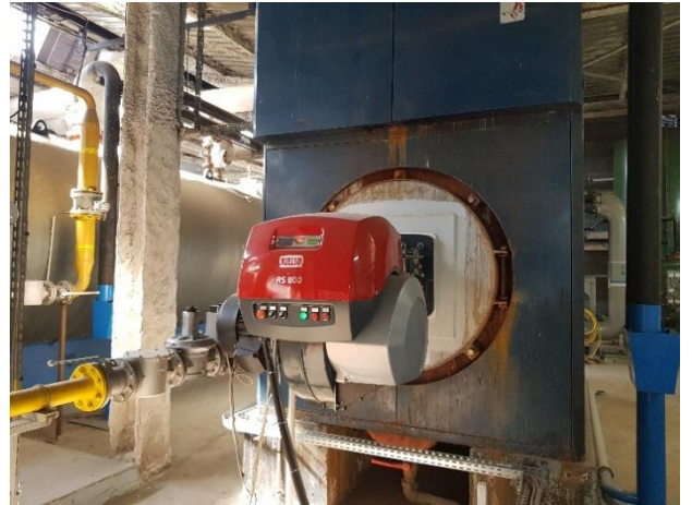
Figure 7 : chaudière numéro 3 avec récupérateur de chaleur
