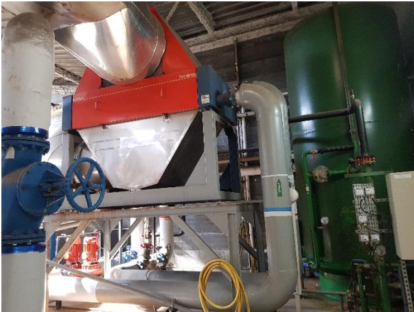
Figure 8 : photo du récupérateur de chaleur
