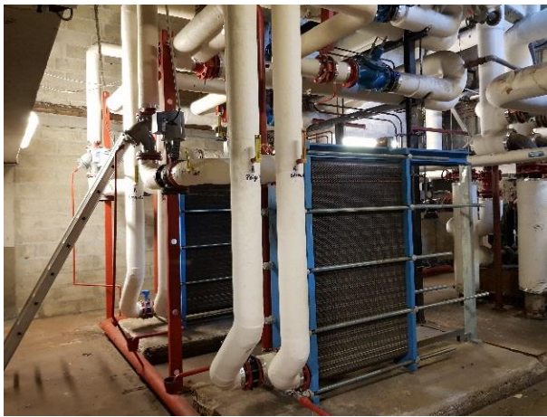
Figure 17: Echangeurs en sous-station (Bondy Habitat)
