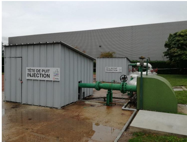
Figure 2. Photographie des têtes de puits
